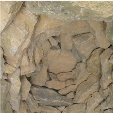
Badens mise en oeuvre des lauzes calcaire vue de l'intérieur d'une capitelle
