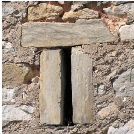
Trassanel : ventilation pour une grange
