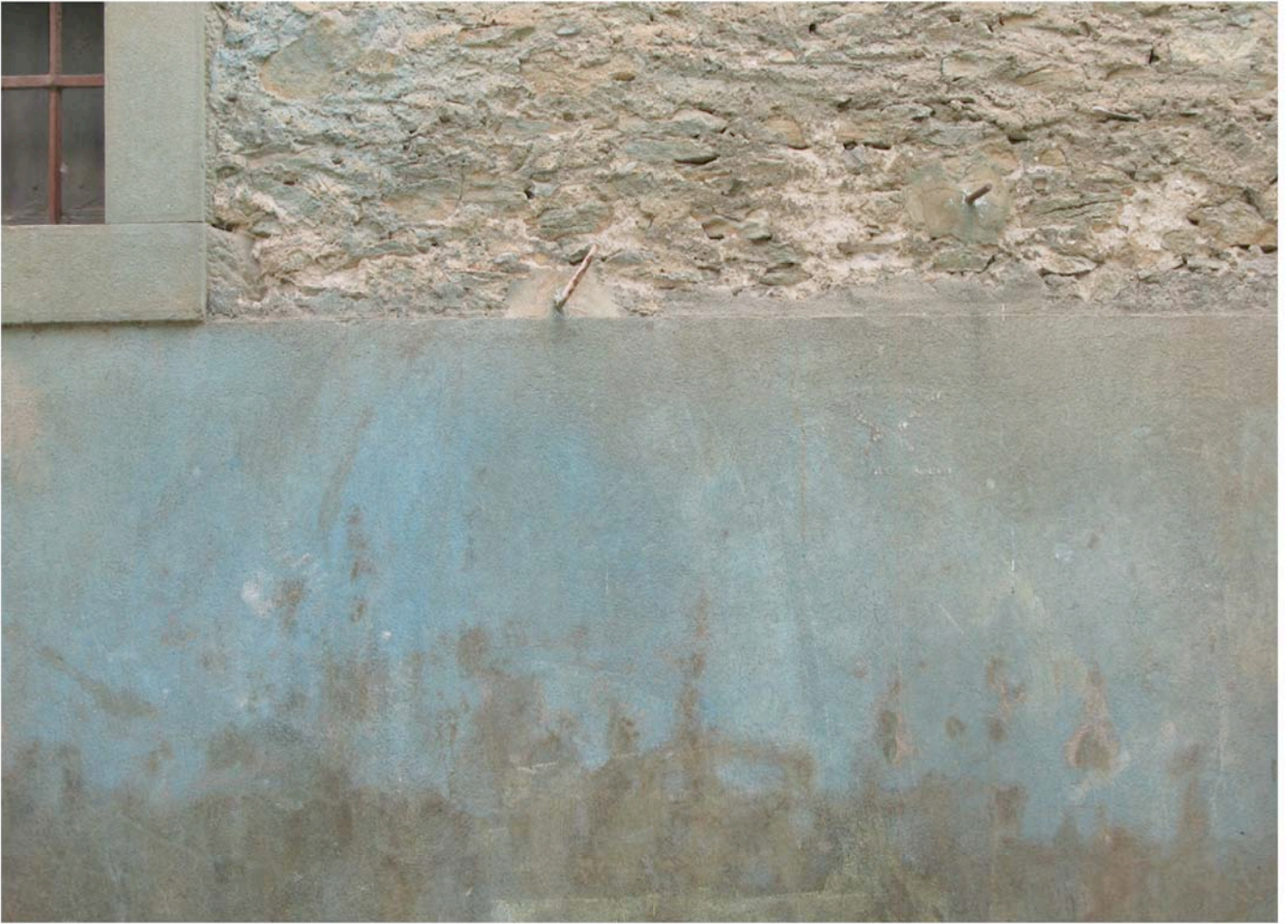
Aigues Vives, sur un chais les traces de la couleur laissée par le cuivre pour le traitement de la vigne
