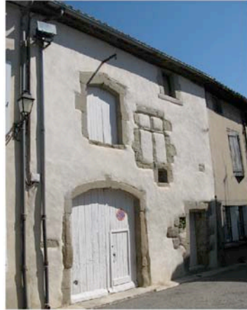
Rieux Minervois reprise d'enduit de façade dont l'épaisseur et les finitions amoindrissent la qualité des détails préservés.
