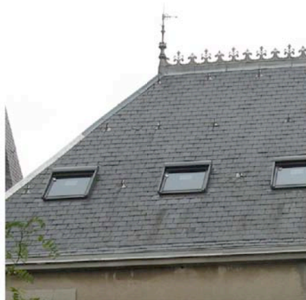
Moussoulens création de fenêtre de toit type «velux» dans un toiture d'ardoises XIX°
