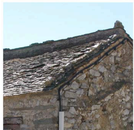
Trassanel couverture d'une bergerie dans le village, les façons de faitage différent selon les cas.
