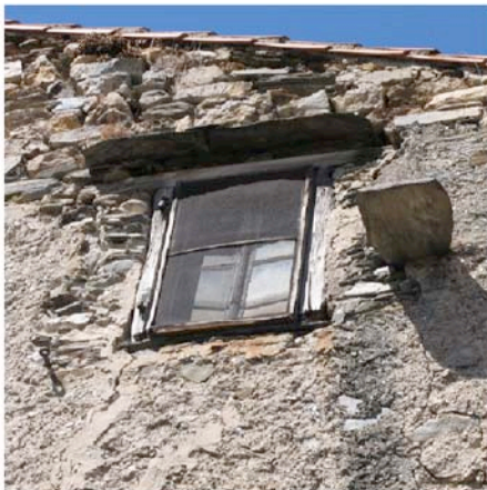
Cabrespine fenêtre de grenier avec détail de protection du cadre bois par une lauze et pierre de repos pour les pigeons
